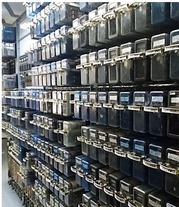
Figura 3. Sala de relee a unei stații echipate CED [12]
