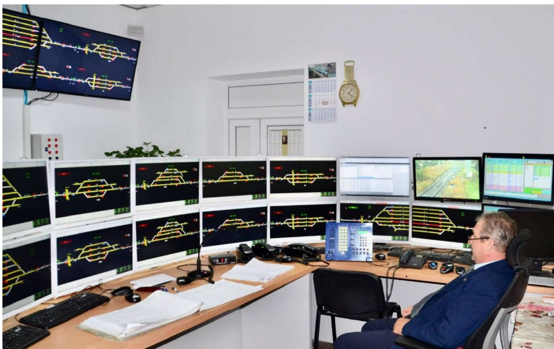
Figura 6. Postul IDM al primei instalații CEL (Siculeni – Adjud) [26]
